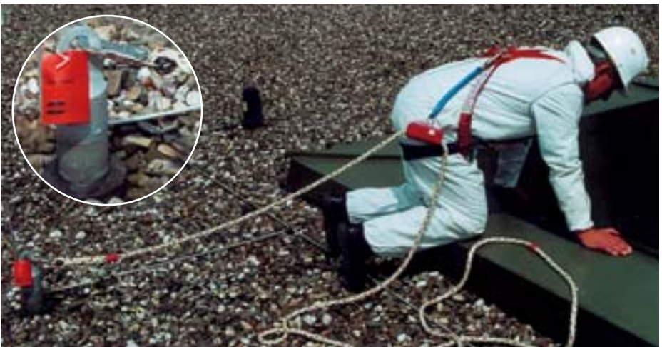
Bild 2-14: Anschlagpunkt auf einem Flachdach
